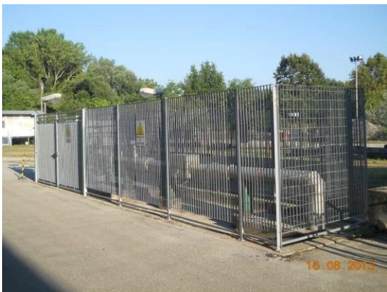
Geothermal well «Vicenza»
